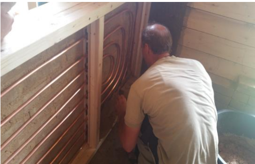
Abbildung 5 – Nachdem das Kupferrohr befestigt und ausgerichtet war, erfolgte die Montage der Aufdoppelungshölzer als Vorbereitung zur Ausfachung mit Lehmsteinen durch Gunther
