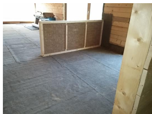
Abbildung 2 – Vorbereitete Holzständerkonstruktion für die Ausfachung mit Lehmsteinen (und Integration des Kupferrohres als Wärmeübertrager)
